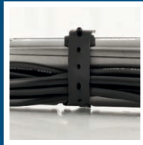
Kaapelinpidin hihnoineen pitää kaapelit järjestyksessä.
